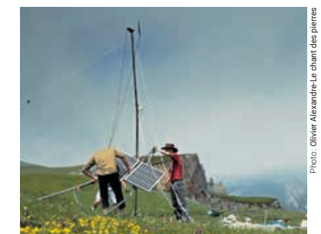
Installation des instruments de mesure et de transmission des données.
